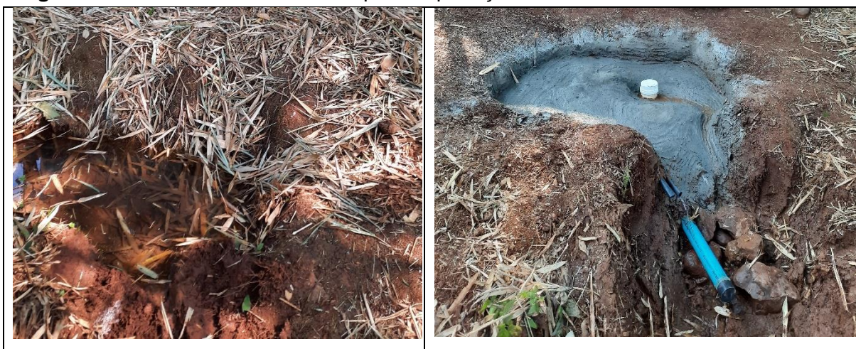
Figura 12. Nascente "9M" antes e depois da proteção com Solo e Cimento – Nova Tebas
