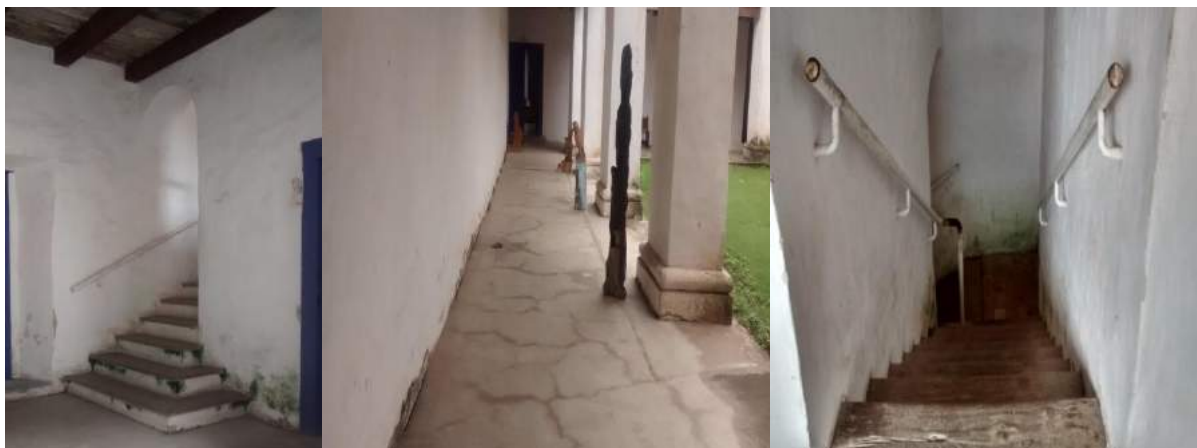
Figura 44: Sinais de ação do tempo na Igreja e Residência dos Reis Magos, Nova Almeida, 2016. Fonte: Arquivo pessoal da autora.
