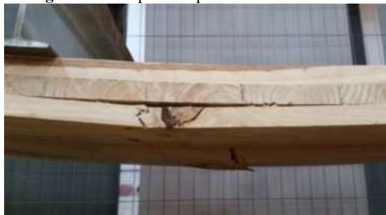
Figura 4.8 – Ruptura do painel P9 testado à flexão
