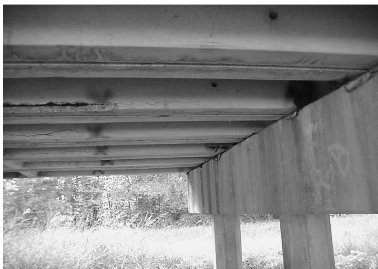
Figura 8 - Foto de deterioração típica: fissuras longitudinais e armadura exposta em viga canal
