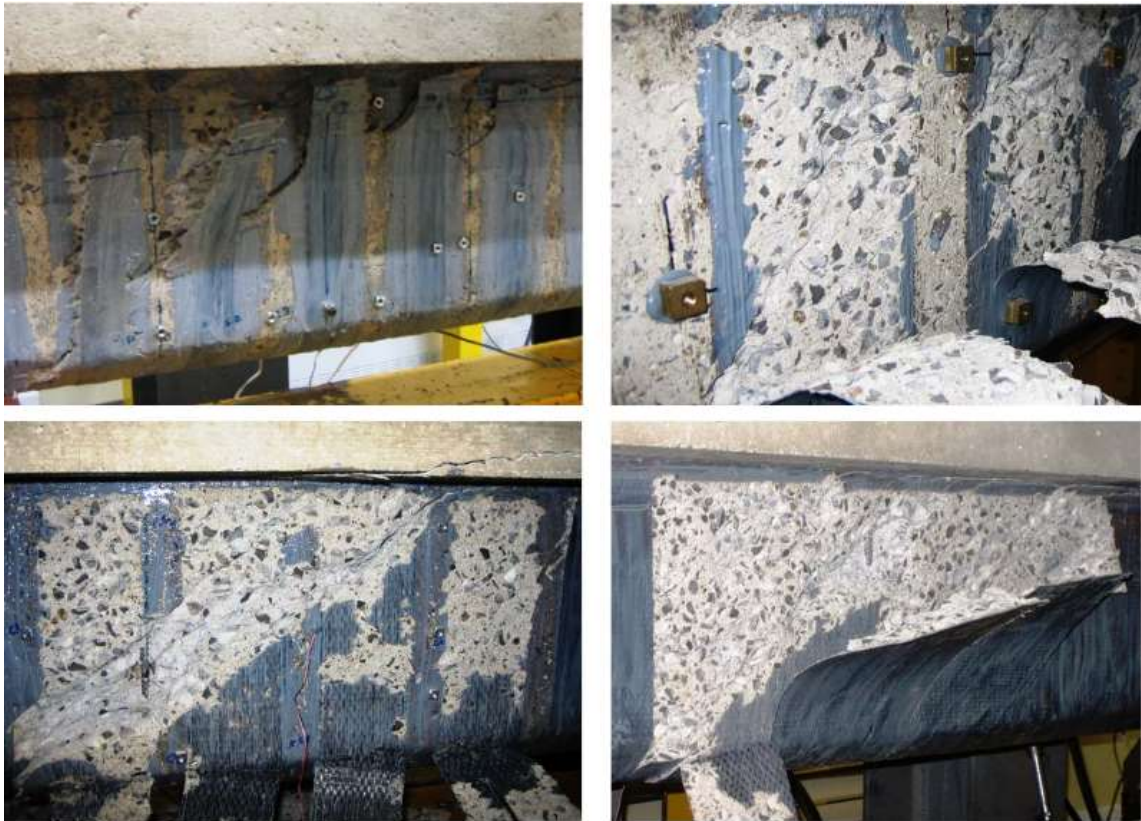
Figura 3.7 – DELAMINAÇÃO NO CONCRETO
