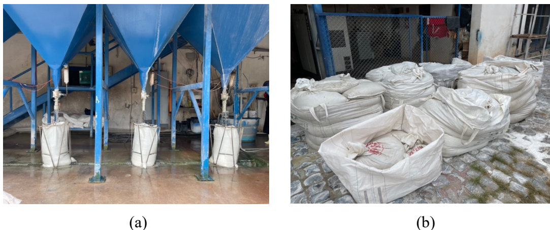
Figura 35 – (a) Válvulas para descarga de resíduo decantado / (b) Sacos com resíduo
