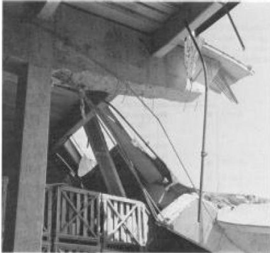
Figura 2.2 - Vigas da estrutura do Hangar Wilkins em ruína
