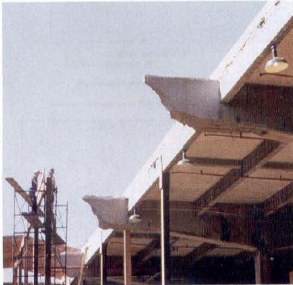
Figura 2.1- Hangar Wilkins após colapso parcial
