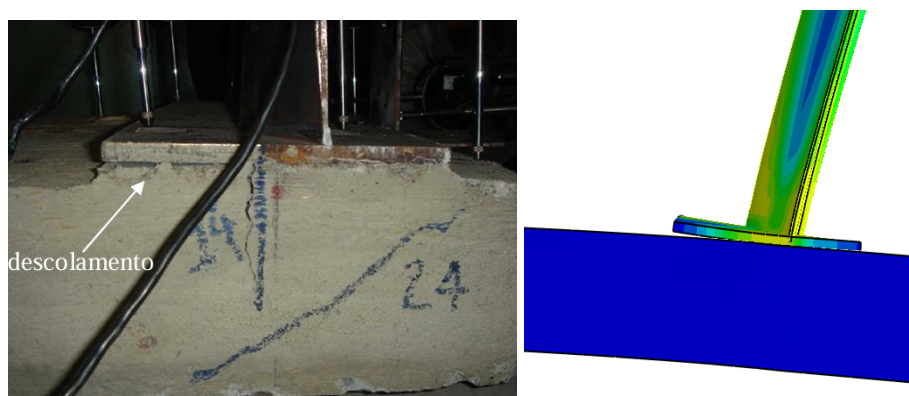
Figura 4.18 – Detalhe do descolamento da mesa superior
