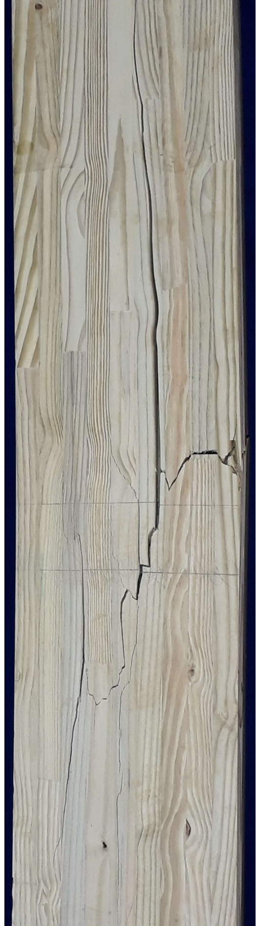
Figura B.5(b) - Ruptura da viga 4: detalhe
