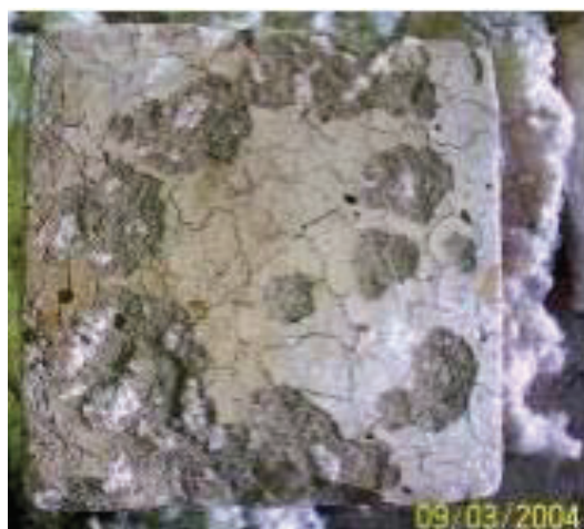
Figura 1.1 – Exemplo de lascamento do concreto
