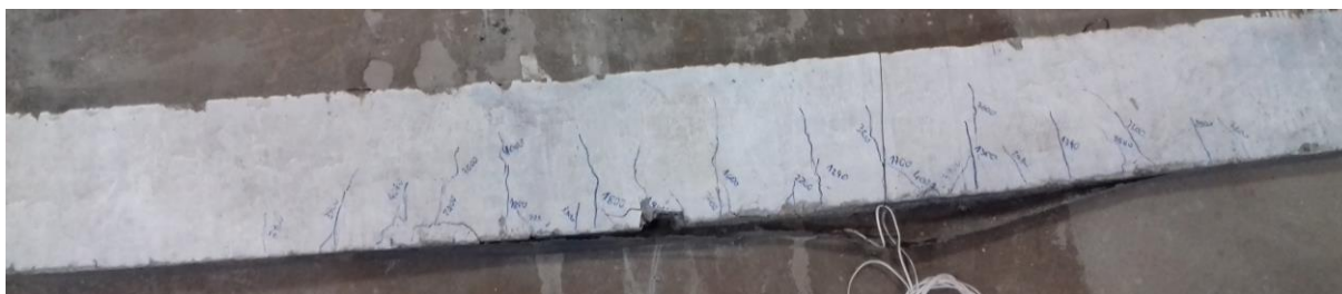
Figura 75 – Fissuras – Viga VF3
