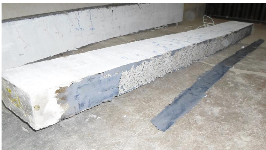
Figura 68 – Ruptura do reforço – Viga VF1
