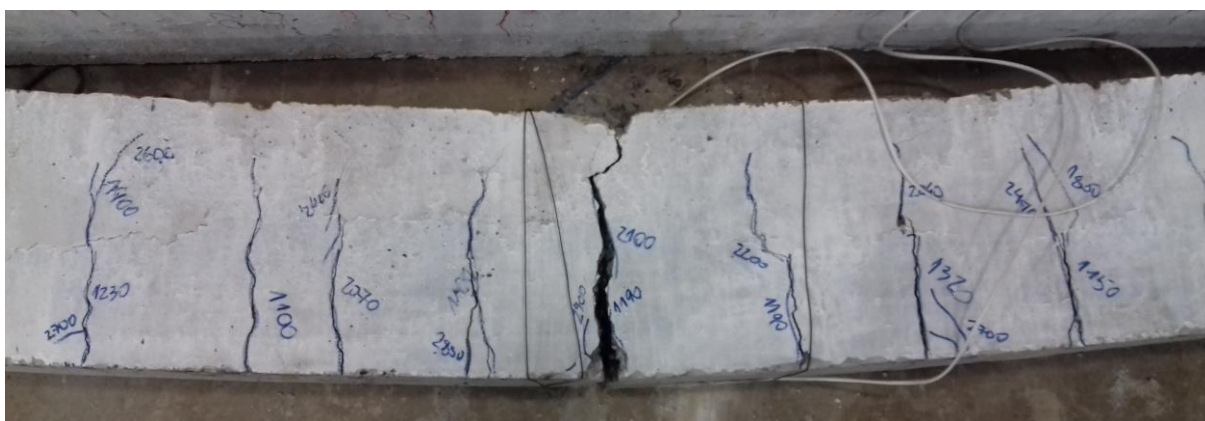
Figura 63 – Fissuras – Viga VFR
