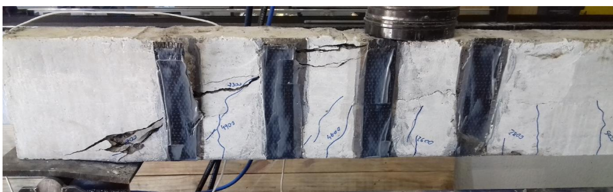
Figura 83 – Fissuras – Viga VC0-90
