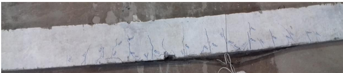
Figura 72 – Fissuras – Viga VF2
