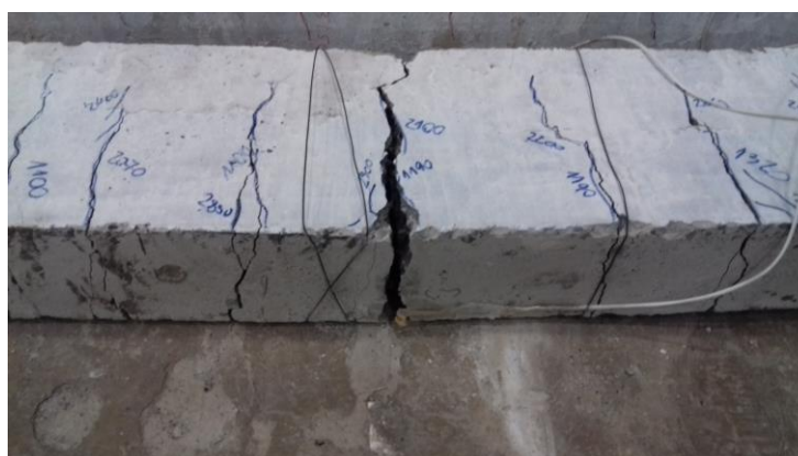
Figura 53 – Marcação das fissuras
