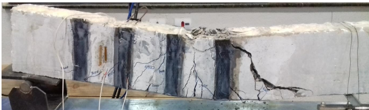
Figura 88 – Fissuras – Viga VC2
