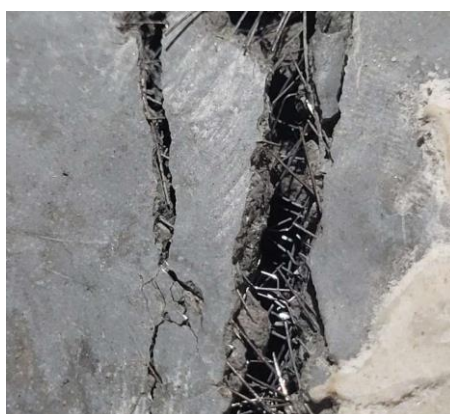
Figura 6 - UHPC: Pontes de transferência de tensão rompidas.
