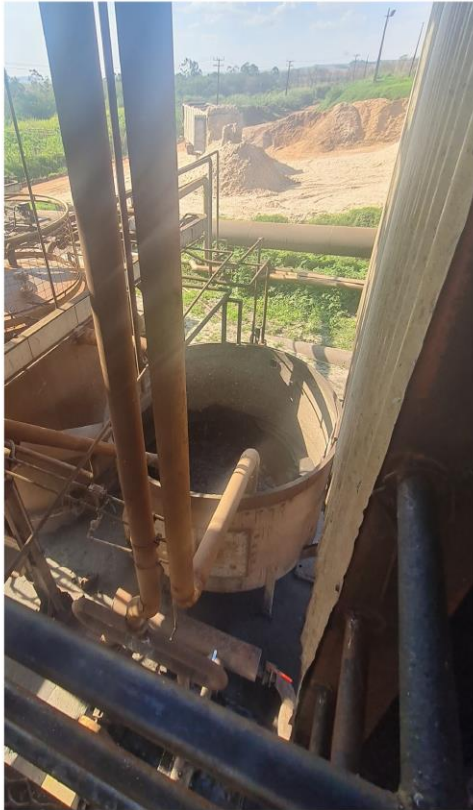
(a) tanque com cinza e água
