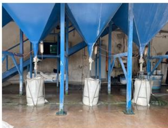
(a) Válvulas para descarga de resíduo decantado
