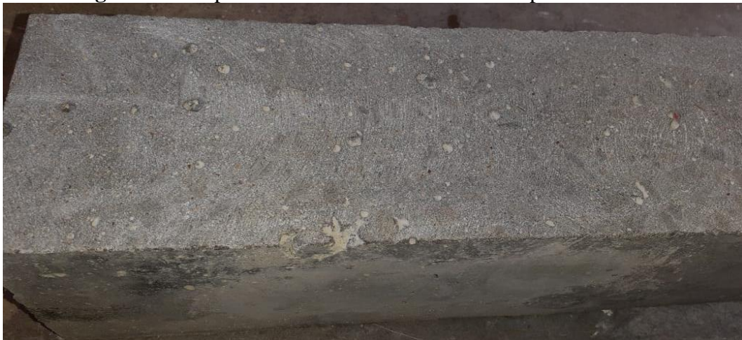
Figura 44 – Superfície do substrato em concreto após o lixamento
