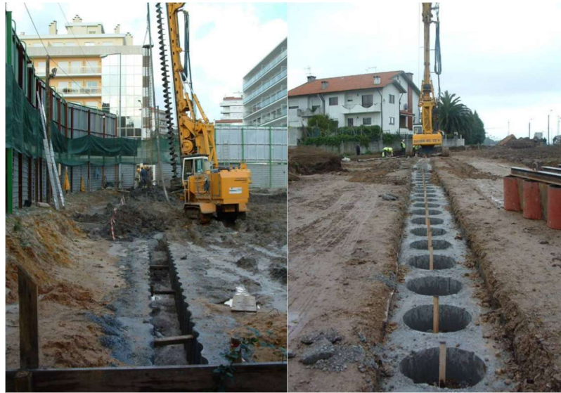
Figura 2.13 – Escavação das estacas nos muros guia para estacas secantes (à esquerda) e para estacas contínuas (à direita)
