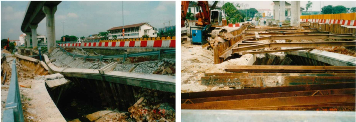
Figura 2.22 – Colapso do dreno de chuvas de monção em cortinas de estacas (a) e escoras internas das cortinas
